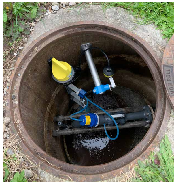
Anwendungsbeispiel: Erfassung des Füllstands durch Ultraschallmessung mit Anbindung an ein Prozessleitsystem inkl. Alarmierung bei hohem Niveau.
