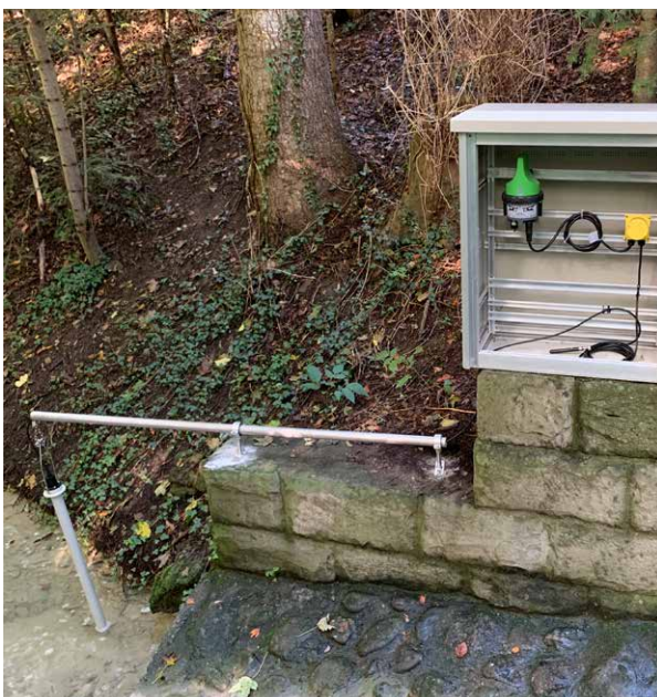
Anwendungsbeispiel: Erfassung des pH-Werts in einem Fließgewässer mit Alarmierung bei Grenzwertüberschreitung per SMS und Darstellung im Webbrowser.
