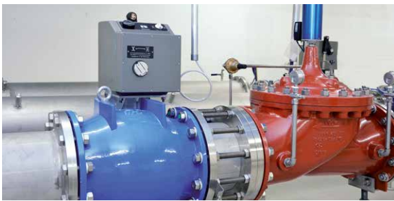
Regulierventil nach Druckreduzierung
