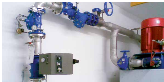
Bypassarmatur bei Trinkwasserturbine
