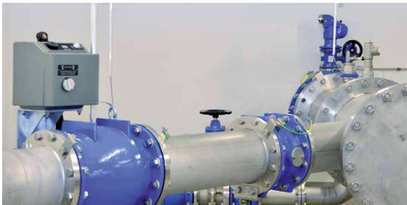
Regulierventil bei Transportleitungsabgang
