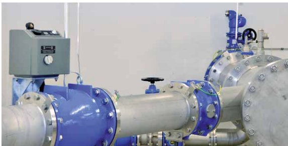
Reguliventil bei Transportleitungsabgang
