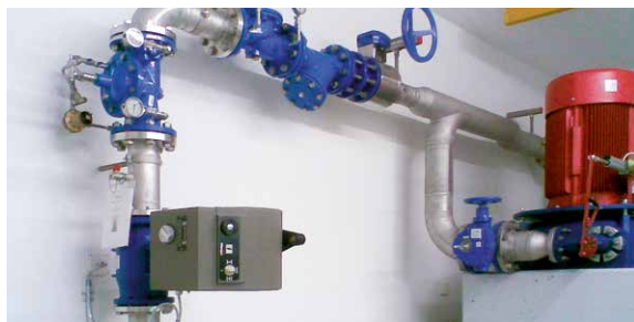
Bypassarmatur bei Trinkwasserturbine
