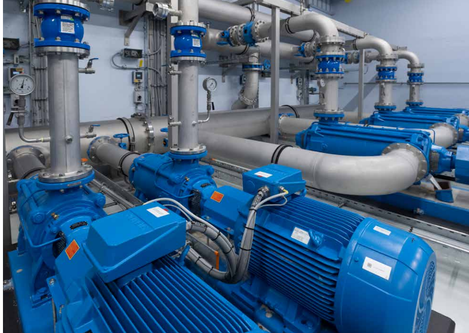
Huit pompes de différentes puissances permettent refouler l'eau traitée vers les deux réservoirs. Les débits refoulés varient entre 1667 l/min (100 m 3 /h) et 30 000 l/min (1800 m 3 /h).
