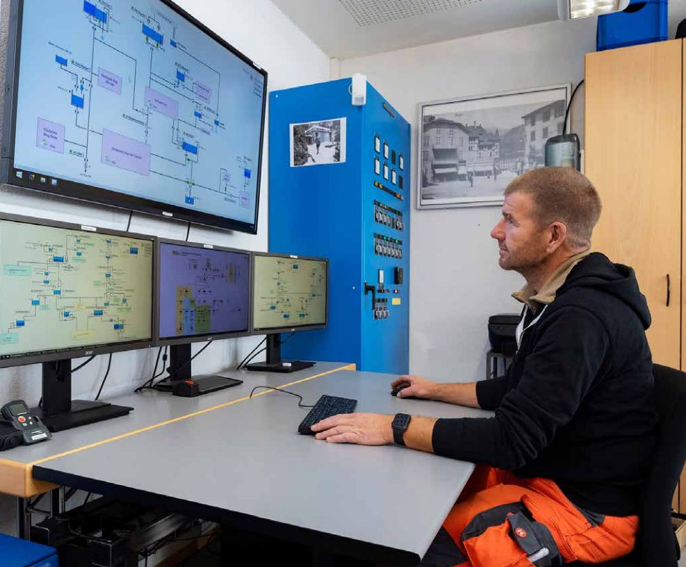
Alles im Blick: Die Qualitätsparameter aus den fünf Messstationen werden ins RITOP-Leitsystem übertragen und sind rund um die Uhr online verfügbar.
