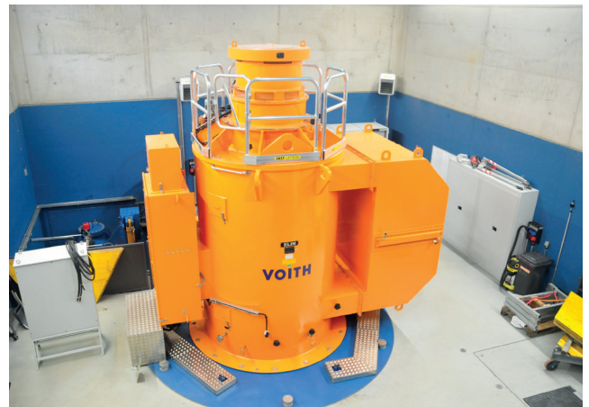
Hier werden im Jahr durchschnittlich 10 GWh Strom erzeugt: die neue vertikal installierte 6-düsige Pelton-turbine
