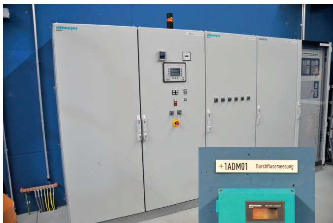
Sämtliche Schaltschränke wurden von Rittmeyer produziert und montiert
