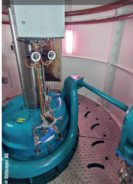
Die installierte Francis-Turbine im Kraftwerk Neuhausen ist auf eine Ausbauleistung von 5,6 MW ausgelegt. Zusammen mit einem direkt angeschlossenen Synchrongenerator erzeugt der Maschinensatz im Regeljahr rund 45 GWh.
